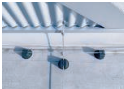
Aansluiting van de metalen gevel op het bliksembeveiligingssysteem
