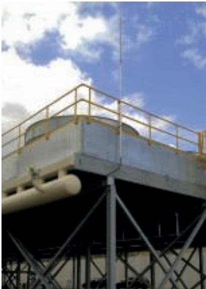
Geïsoleerd afleidingssysteem in explosiegevaarlijke omgeving
