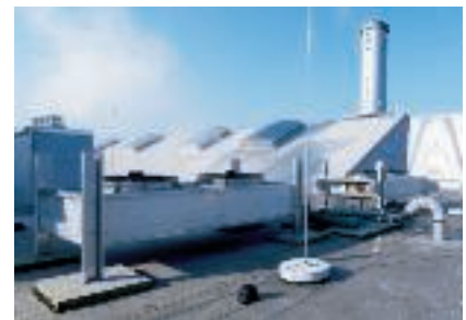
Geïsoleerde bliksembeveiliging op dakelementen
