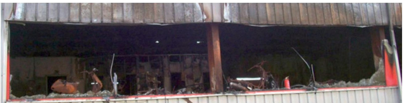
Brandschade door corrosieve gassen
