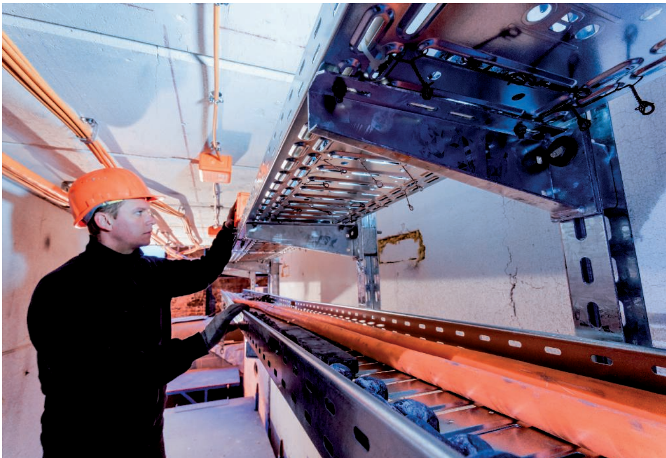
Testopstelling van een kabelinstallatie met functiebehoud
