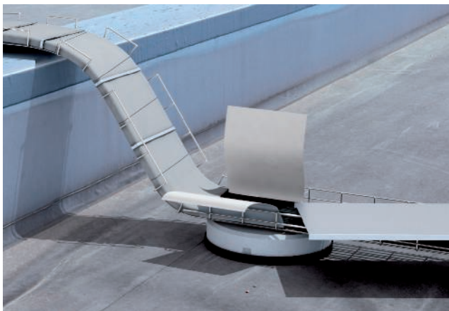
Over de brandwand geïnstalleerde leidingen met bandage
