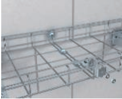
Verbinding C-draadgoot Het verbinden van de C-draadgoten met de verbinders type GSV 34.
