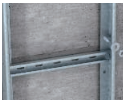
Directe wandmontage Directe bevestiging van de verticale ladder LG en SSL met keilbouten aan de wand.
