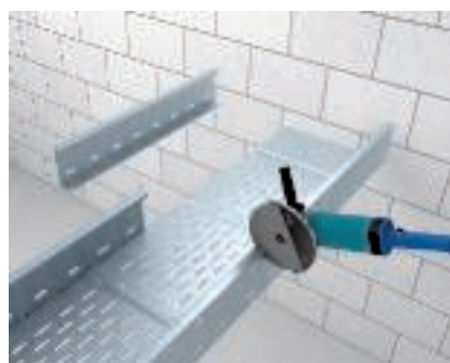
Maken van een T-aftakking met hoekaanbouwstuk Verwijderen van de zijkant uit de verspankabelgoot.
